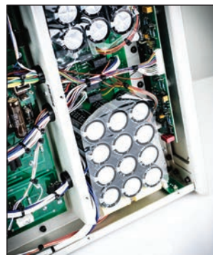
Kondensatory przykryto folią, by zapobiec przypadkowemu rozładowaniu.
